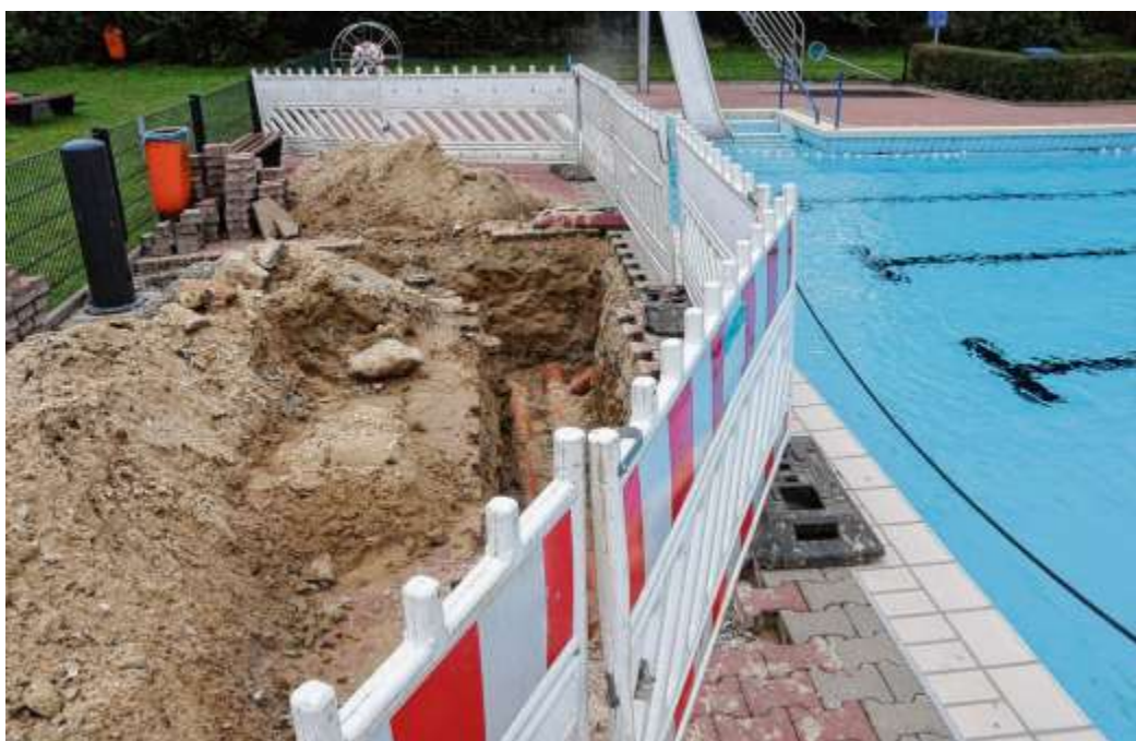
Fehlzanzeige: Die Stadt hatte gehofft, den Schaden in einem defekten Rohr an der kurzen Seite des Beckens ausgemacht zu haben. Doch Grabungsarbeiten haben gezeigt, dass die Leitung intakt ist; das Leck muss sich also an anderer Stelle befinden.
